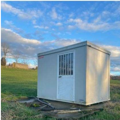
Abri fermé à clé, hors gel, placé sur la margelle, abritant tête de puits et installations liées au forage
